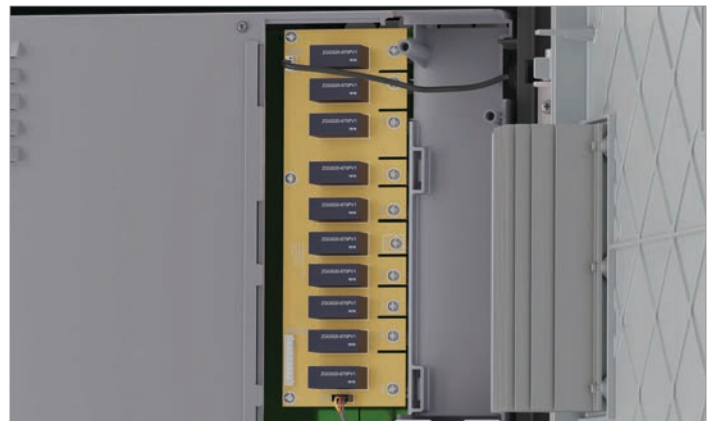
Abb. 4.11: Position der DC-Überspannungsableiter bei entfernter Abdeckung
