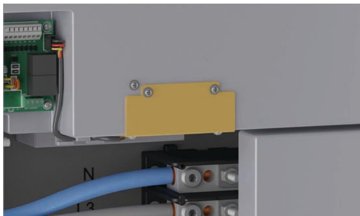
Posición del ventilador 1 interno
