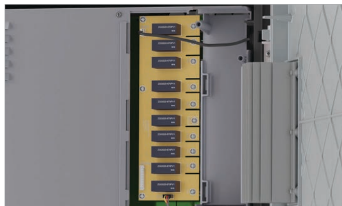
Afb. 4.11: Weergave van de DC-overspanningsafleiders bij verwijderde afdekking
